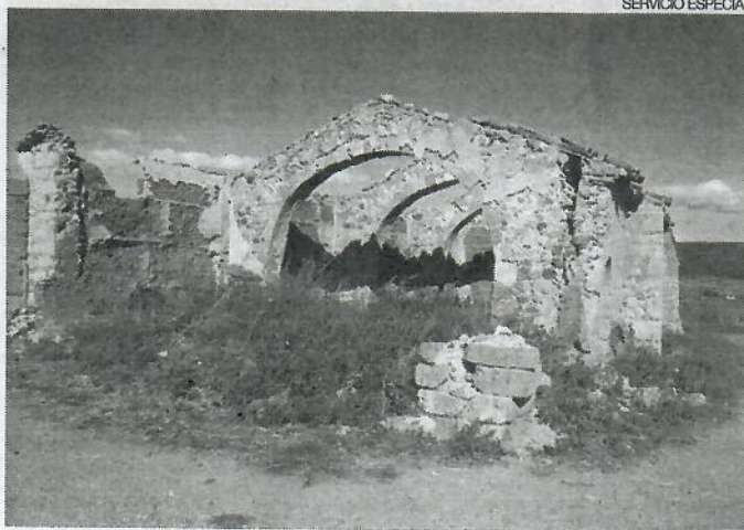
►► El edificio amenazaba ruina total.
